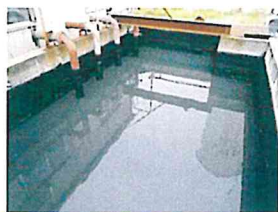
冷却塔ピット
