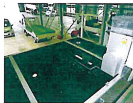
連続式凝集分離装置
