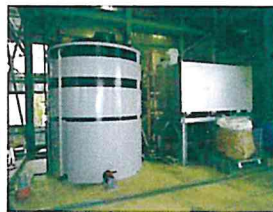
廃水処理設備
